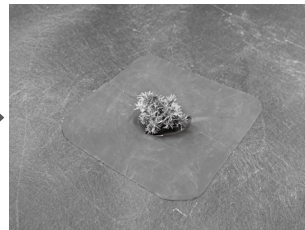
固定後、シート上より水やりを行い、施工完了となります。
